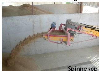
Cellule de stockage de céréales en vrac sous hangar
