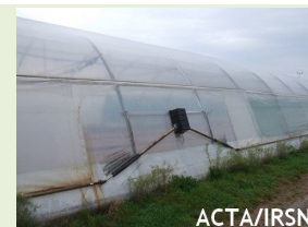
ACTA/IRSN Systèmes d'aération d'un tunnel plastique
